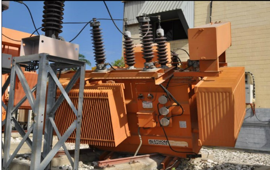
Figura 2.5: Subestación en Haití, 2010
