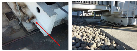
Figura 5.8: El ancla alcanzó la fluencia producida por el esfuerzo cortante causado por el sismo
