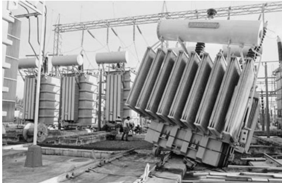
Figura 2.4: Subestación en Edgecumbe, Nueva Zelanda, 1987
