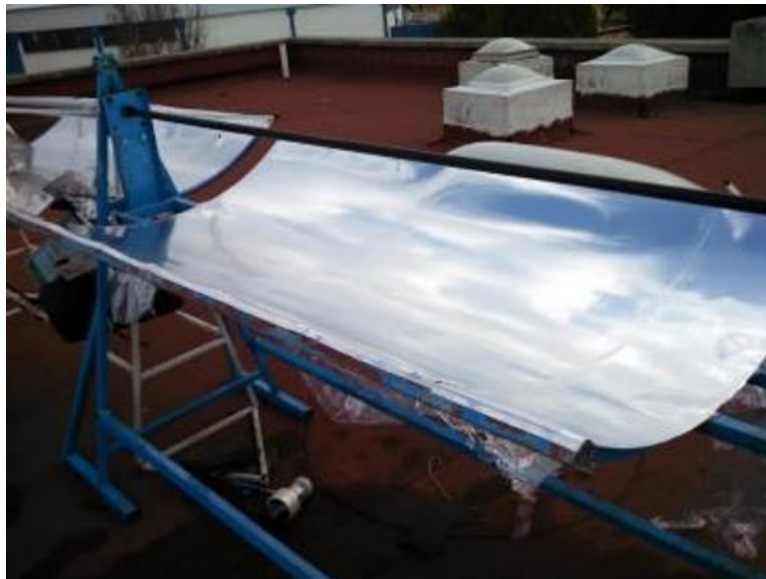
Figura 26: Concentrador solar instalado en el Instituto Tecnológico de Pachuca
