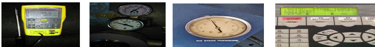
Figura 5 Instrumentos de medición (Medidor de temperatura digital, medidor de temperatura de presión, manómetro de burdon, tablero de medición de compresor)
