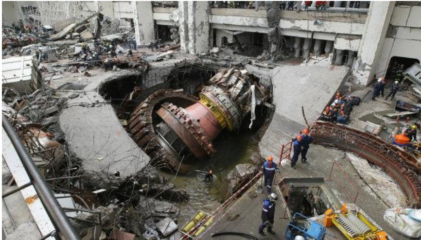
Fig. 2.2 Catástrofe debido a falla en rotor
