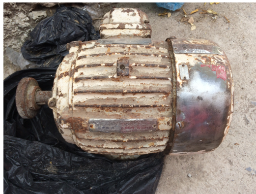
Figura 5.9: Carcasa oxidada del motor.
