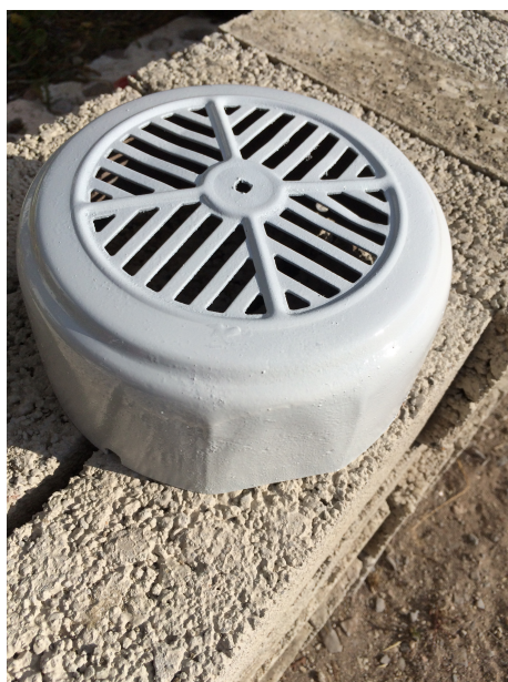
Figura 5.11: Guarda del ventilador del motor ya pintada.
